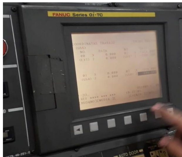
Imagen 2.5.- Panel del controlador libre de alarmas
